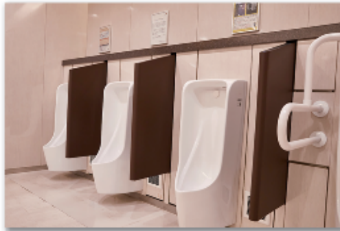
間仕切りに超小型ファンを取り付けた駒門PA(下)の臭気対策
