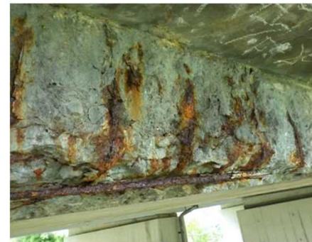
損傷状況(大沢川橋)
