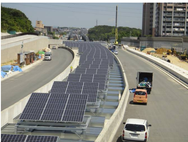
掘割部区間に設置した太陽光パネル
