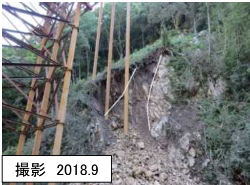
のり面の崩落
