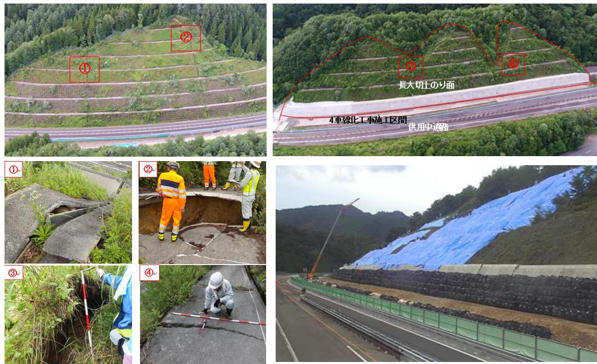
(大雨による切土のり面の変状の状況)
