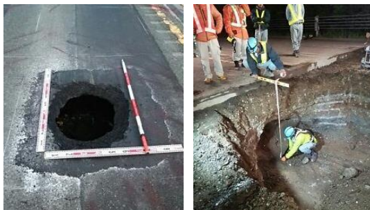
(路面陥没〔左〕と開削による調査〔右〕の状況)
