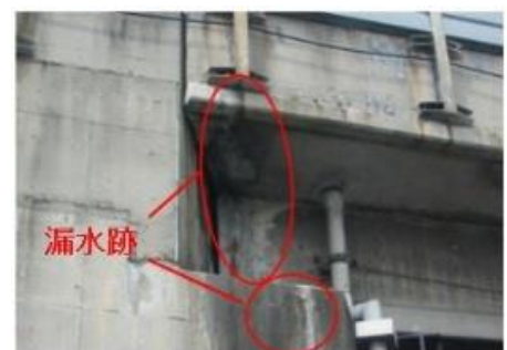
(桁端部からの漏水状況)
