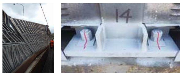
（遮音壁の傾倒事象〔左〕と再発防止状況〔右〕）
