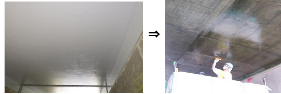
(現状のはく落防止対策シート)
