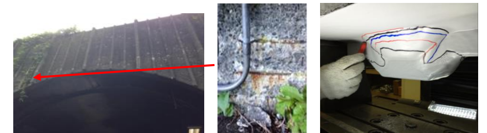
劣化した坑門壁面
