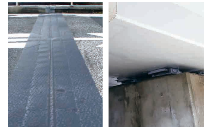
伸縮装置からの漏水対策
