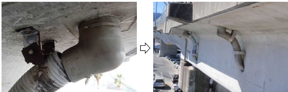
【速やかな対策が必要な変状の措置事例(排水管の変状)】
