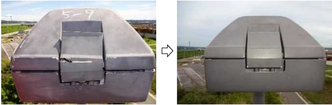
【速やかな対策が必要な変状の措置事例(道路照明灯具の腐食)】
