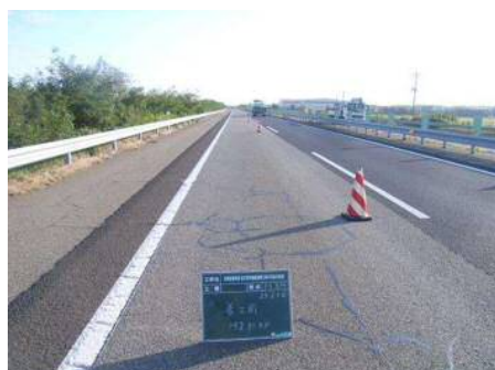
【舗装補修(施工前)】
