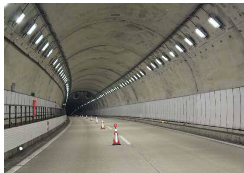
【更新後(LED照明)】
