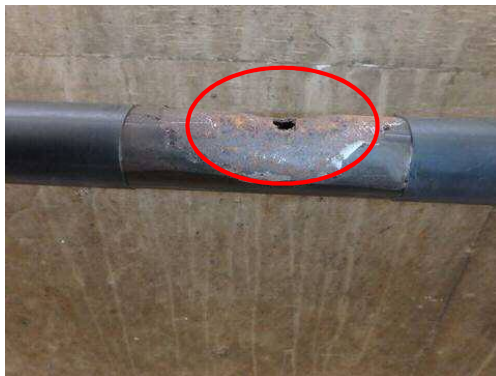
【通信管路腐食状況】
