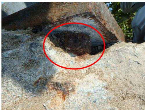
【アンカーボルトの腐食状況】
