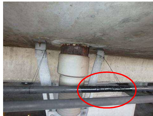
【防食テープにて仮処理】
