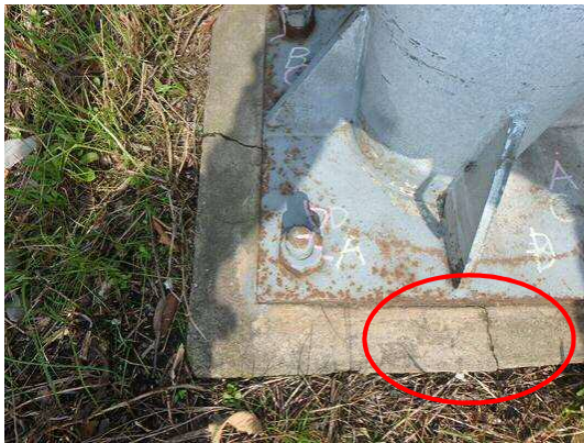
【基礎のクラック状況】
