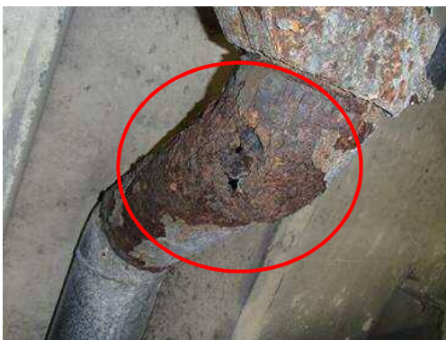
【トンネル防災水管の腐食状況】
