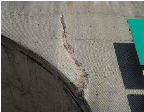
【面壁のクラック】
