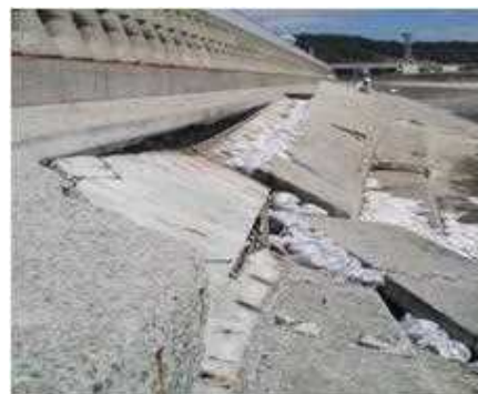
護岸変状状況
