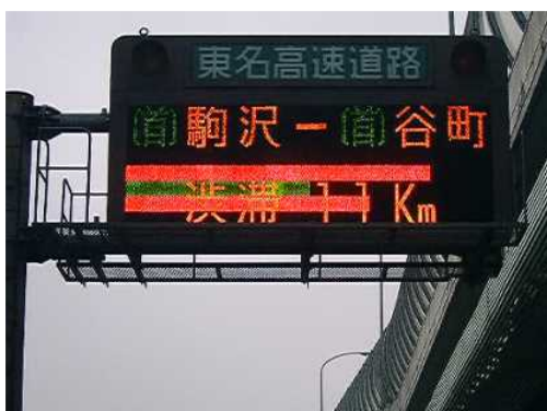
(経年劣化によるLEDユニットの故障)
