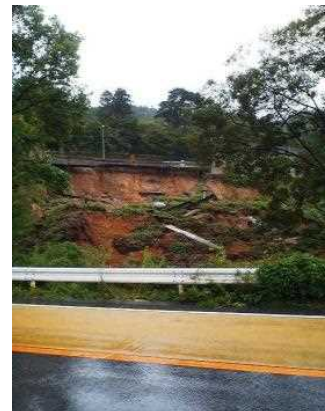
被災状況(全景)
