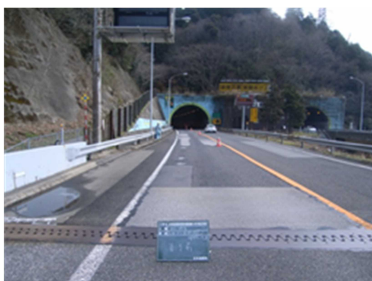
《舗装補修(施工前)》
