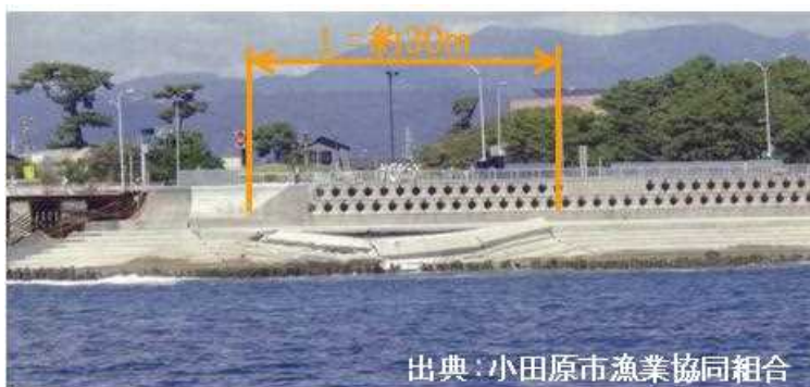
盛土のり面崩落
