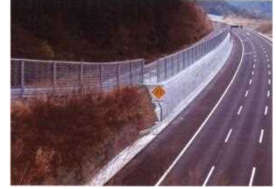
本対策状況(落石防止柵)
