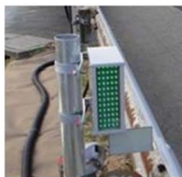
灯具設置状況写真
