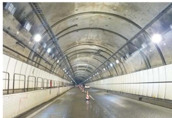
《LED照明の状況》
