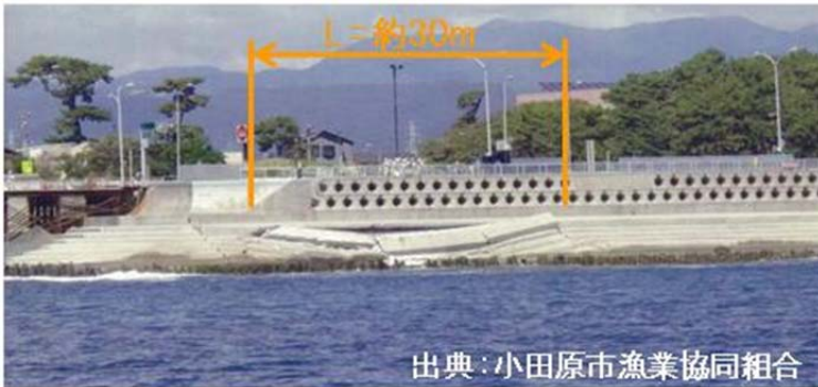
盛土のり面崩落
