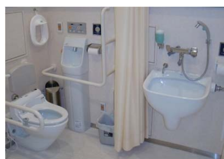
オストメイト設備の整備
