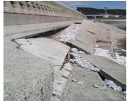
護岸変状状況
