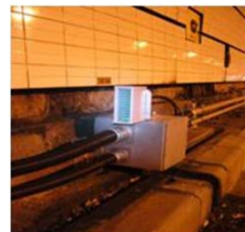
トンネル部灯具写真
