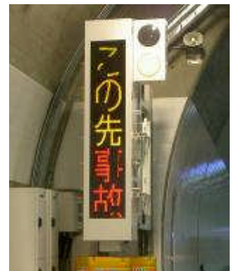
＜施設設備の損傷事例＞ 情報板の表示部劣化
