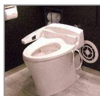
大便器の洋式化及び 洗浄器付便座
