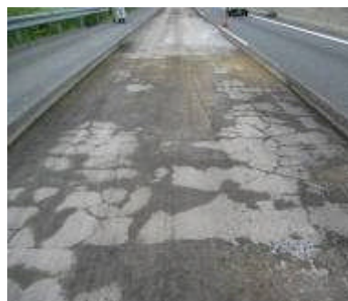
＜舗装の損傷事例＞ 道路基層面のひび割れ
