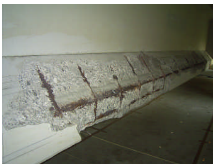
＜橋梁の損傷事例＞ 飛来塩分による損傷
