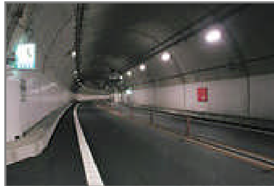
《蛍光灯照明の状況》
