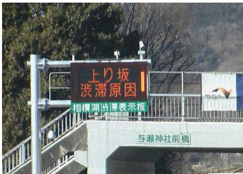
中央道 相模湖インターチェンジ付近に設置したLED速度回復情報版
