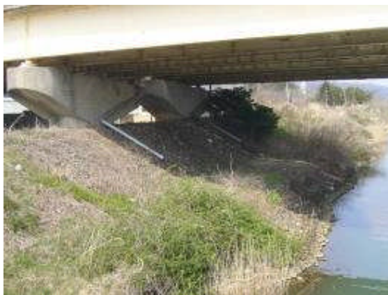
《橋脚補強(施工前)》
