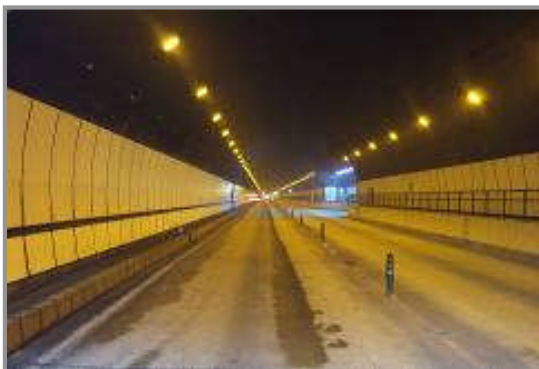
《ナトリウム灯照明の状況》
