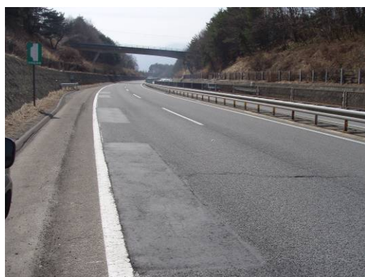
《舗装補修(施工前)》
