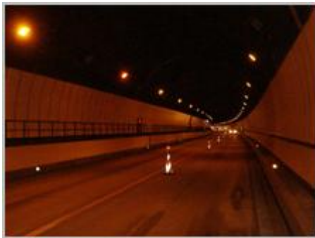
《ナトリウム灯照明の状況》
