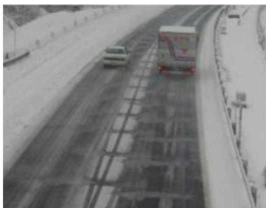
定置式溶液散布装置稼働状況 (北陸自動車道下り61.4KP付近)
