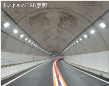
トンネルのLED照明
