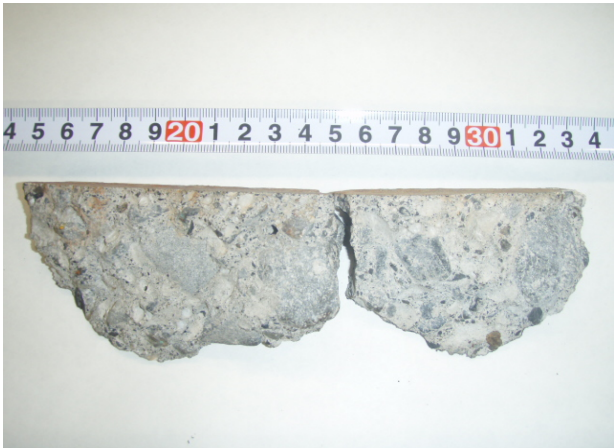
落下コンクリート片
