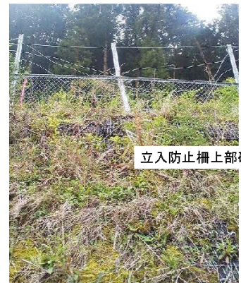
立入防止柵破損状況
