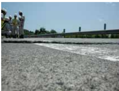
損傷状況：コンクリート舗装の段差
