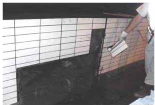
トンネル内装タイルの損傷
