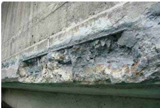
橋梁張出部のコンクリートはく離
