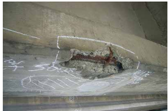
コンクリート桁のはく離
