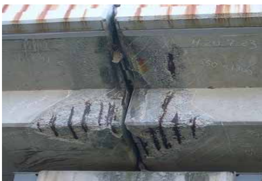
漏水による桁端部のコンクリートはく離
