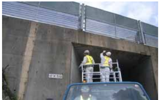
加圧ボックส์点検
