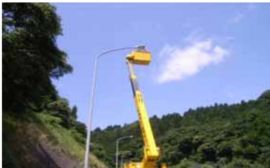
照明設備の点検
