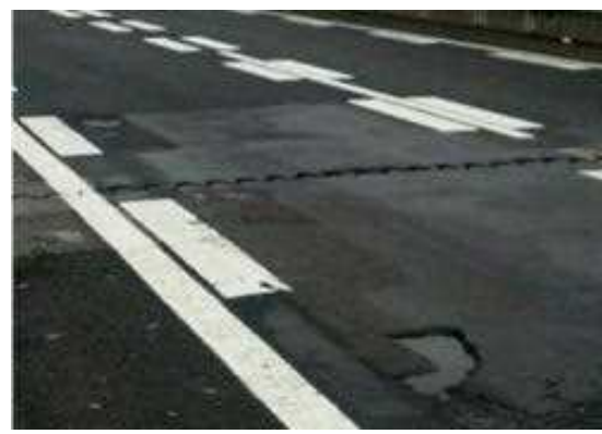
舗装の損傷状況
