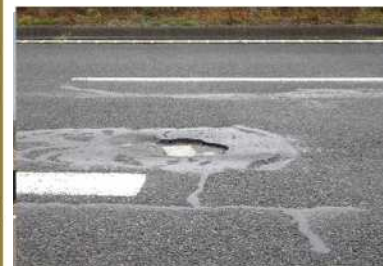
舗装の損傷状況
