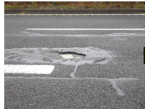
舗装の損傷状況
