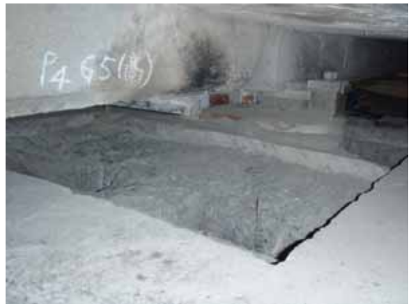
支承撤去後 埋込み長不足のためアンカーボルトが確認できない
