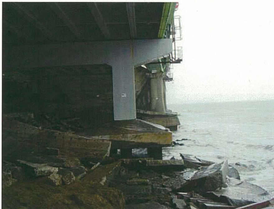
被災直後状況写真(金波橋の下から大磯方面) 平成19年9月撮影
