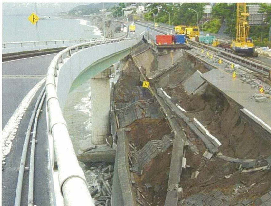
被災直後状況写真(西湘二宮ICから橋IC方面) 平成19年9月撮影
