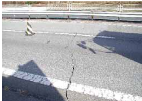
既設コンクリート舗装面のクラックの状況
