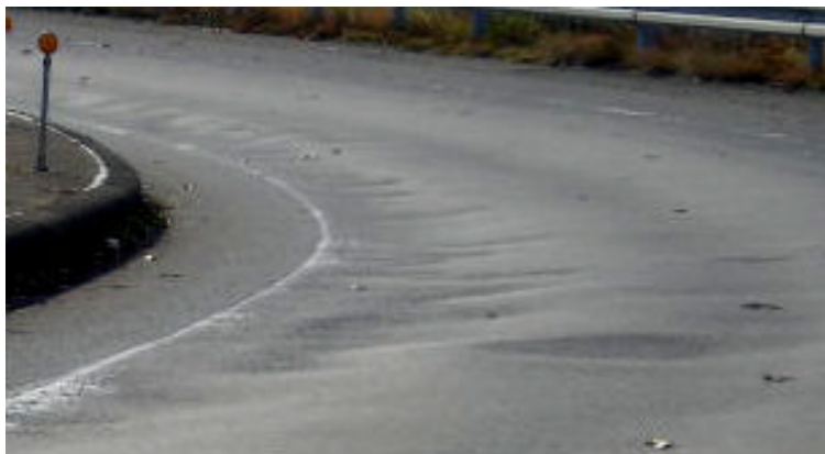
【連続した路面のわだち掘れ状況】
