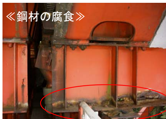
《鋼製支承の腐食》
