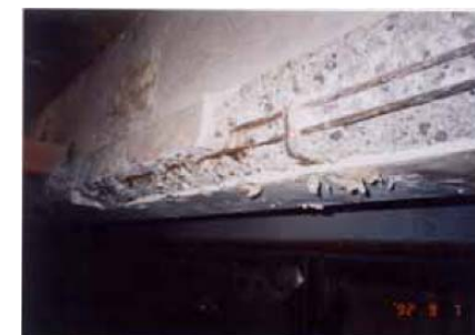
鉄筋露出損傷状況 (H4年時点)
