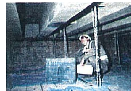
小規模な断面修復 (H4年時点)
