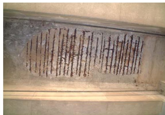
凍結防止剤による塩害被害
