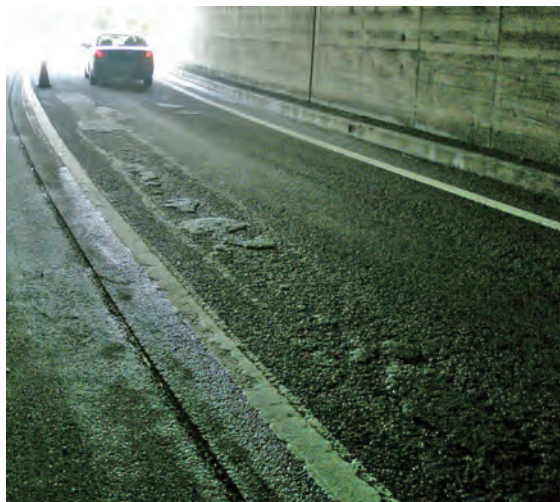
損傷した舗装路面の状況
