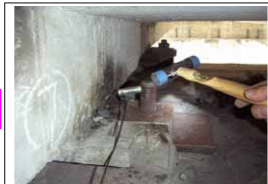
鉄筋振動の卓越周波数 (振動加速度法試験)
