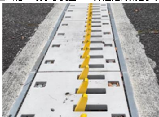
路面埋込型ブレード（郡上八幡 IC）
