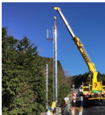
道路管理用カメラ設置状況
