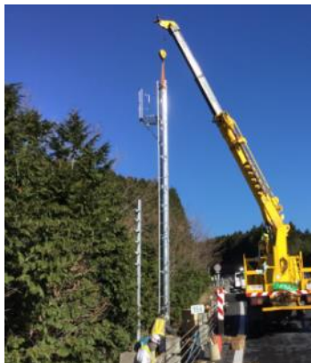
道路管理用カメラの設置状況
