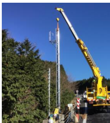
道路管理用カメラ設置状況
