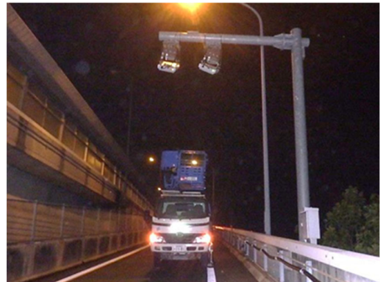
通信設備の点検
