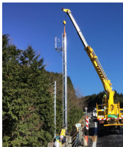
CCTV カメラ設置状況
