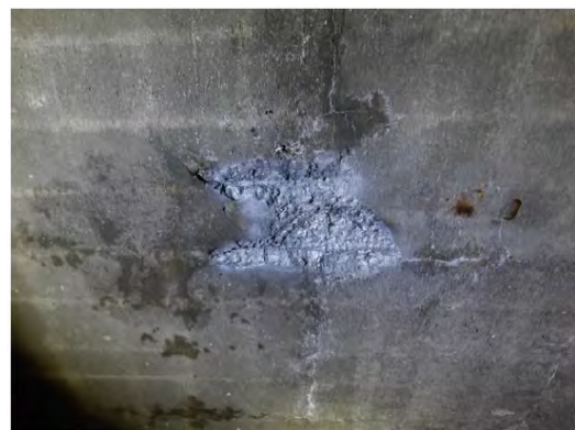
床版下面の損傷状況
