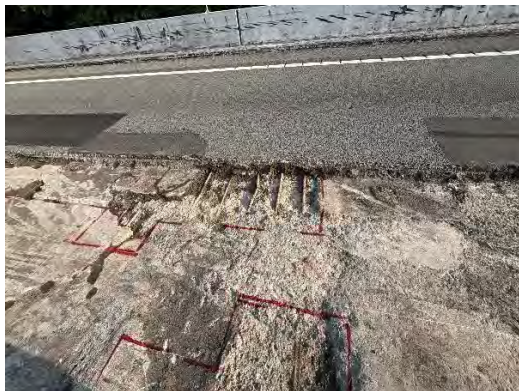
床版上面の損傷状況
