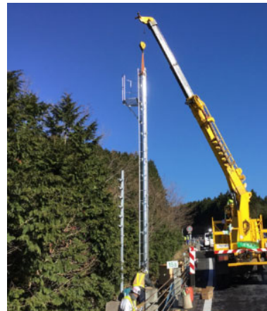
CCTVカメラの設置状況
