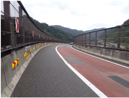
舗装の損傷状況
