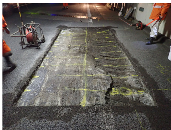
床版上面の状況
