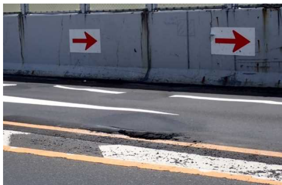
舗装の損傷状況イメージ
