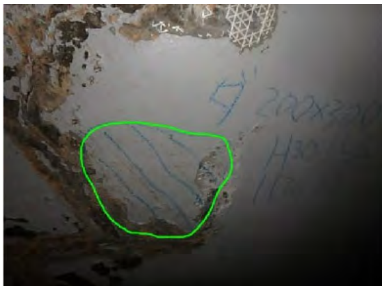
床版裏側の状況(シート背面の剥離あり)
