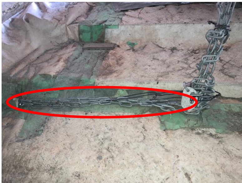
垂れ下がっていたチェーン（足場内回収済み）
