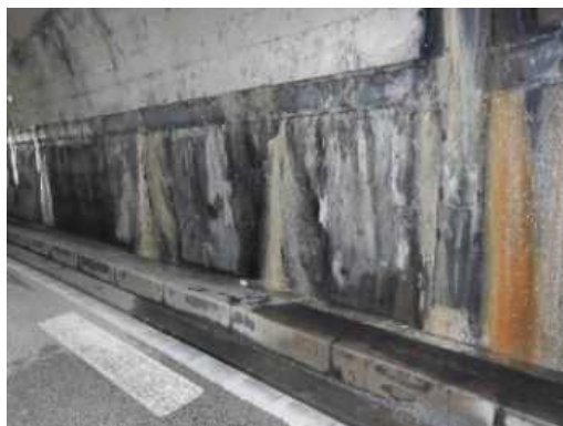
トンネル覆工の劣化状況
