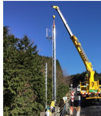
CCTV カメラの設置状況
