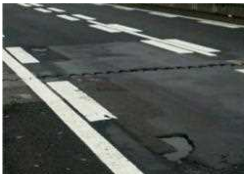
舗装の損傷状態イメージ
