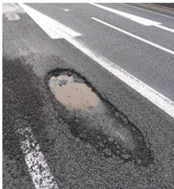
降雨時の路面損傷の例
