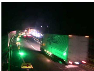
視線誘導の設置例
