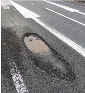
降雨時の路面損傷の例
