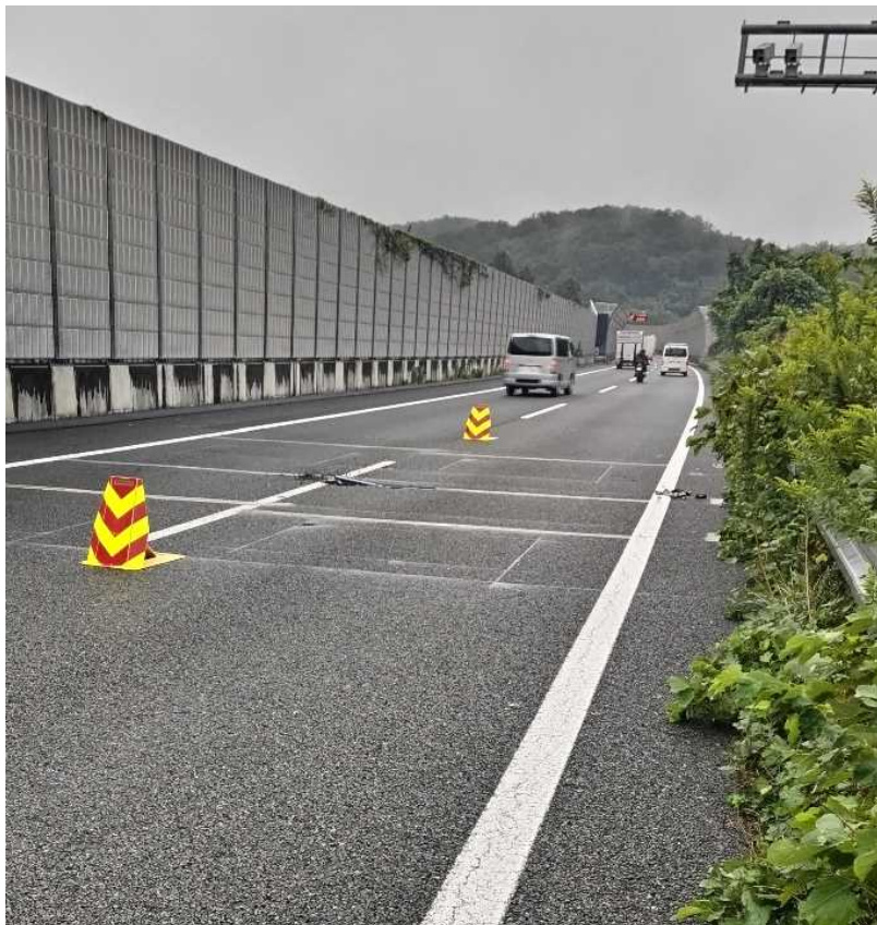
自動軸重計設備設置状況
