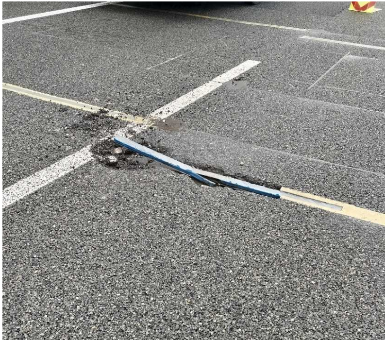
自動軸重計設備とその周辺の舗装の破損状況
